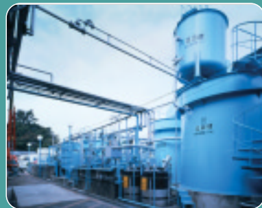
公害対策として設置された追浜事業所の排水処理タンク（1972年）
