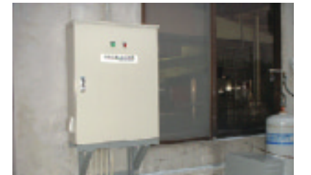
油脂分解・浄化装置を設置（高島事業所）
