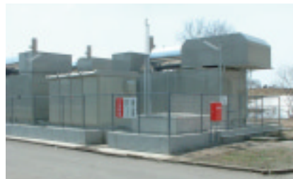
高島事業所が導入した自家発電装置
