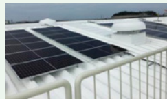
追浜事業所に設置された 太陽光発電設備
